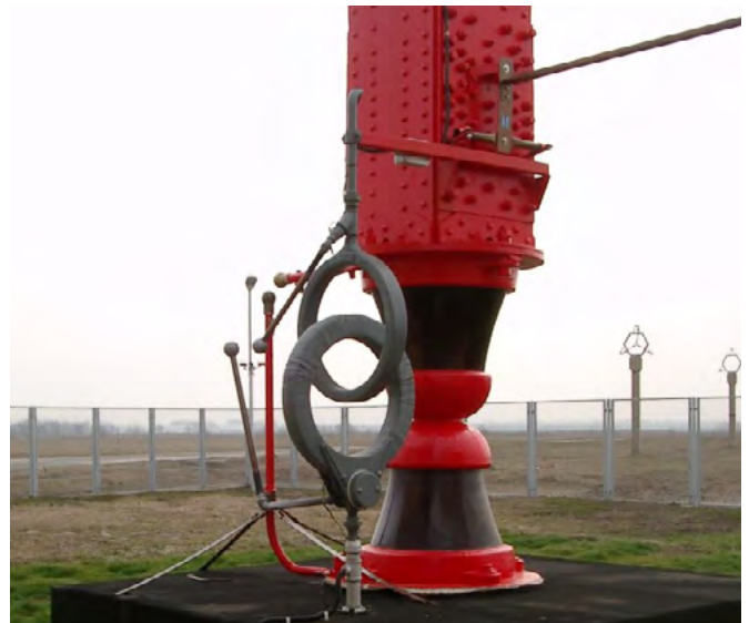
16. ábra A lakihegyi toronyantenna talpszigetelője az Austin transzformátorral és szikraközökkel. Jól látható a betápláló rézvezeték
